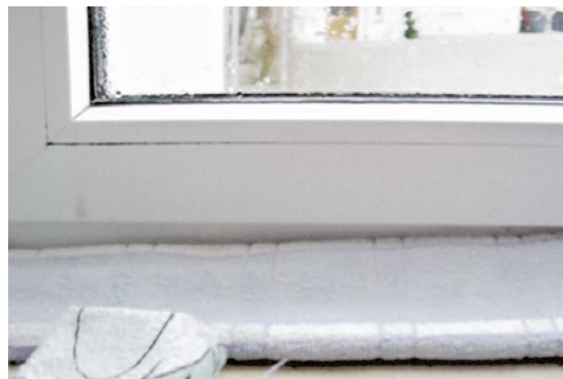
Abbildung 9 Starker Tauwasserausfall am Randverbund des Glases
