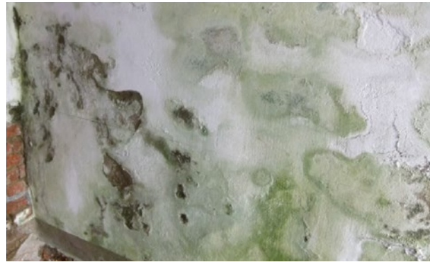
Abbildung 59 Extrem durchfeuchtetes Außenmauerwerk
