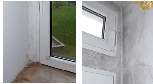
Abbildung 85/86 Bildung von Stockflecken durch Kondensatausfall an den angrenzenden Wandoberflächen
