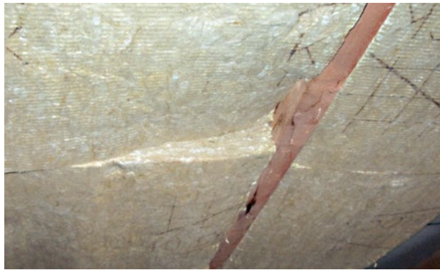
Abbildung 32 Zusammgedrückte Wärmedämmung zwischen den Sparren
