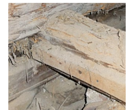
Abbildung 5 Problemstelle Auflagerbereich für Fußschwelle und Balkenköpfe
