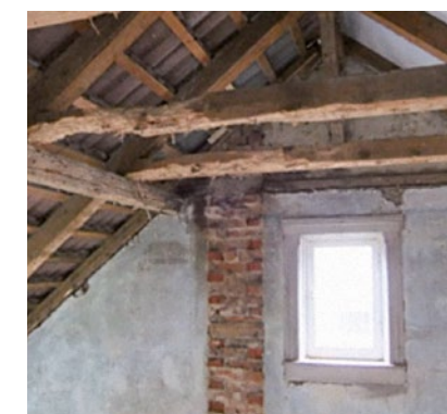
Abbildung 4 Nicht mehr tragfähige Kehlbalke durch Schädlingsbefall
