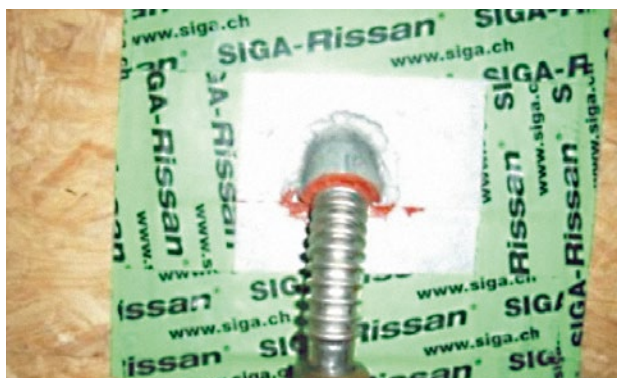
Abbildung 49 Rohrleitungsanschluss mit Anschlussplatte einer solarthermischen Anlage
